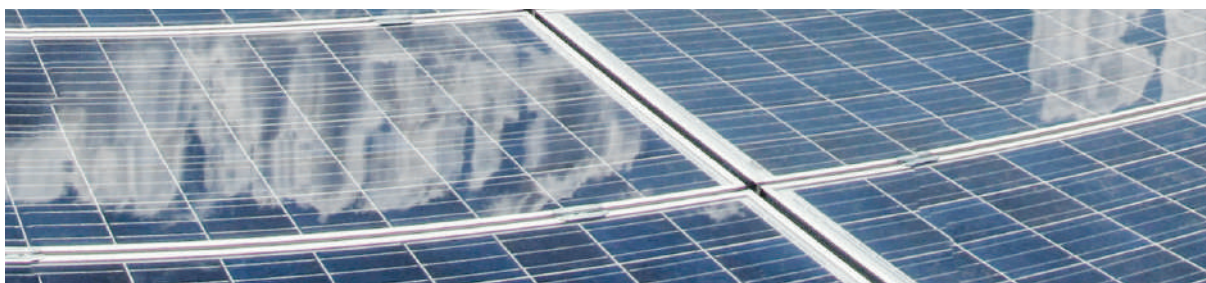
Impianto fotovoltaico installato sui tetti dello stabilimento METALSISTEM a Rovereto
